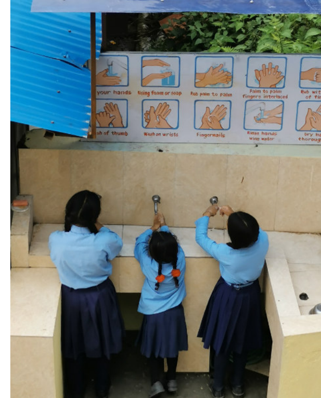
An der Tarebhir Grundschule wurde eine Waschstation gebaut, um den Kindern effektives Händewaschen zu ermöglichen.
